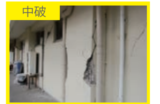
柱にせん断ひび割れ・曲げひび割れ、耐力壁にひび割れが見られ、RC二次壁・非構造体に大きな損傷あり。
