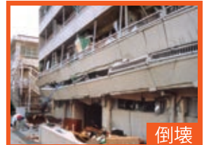
柱・耐力壁が大破壊し、建物全体または建物の一部が崩壊している。
