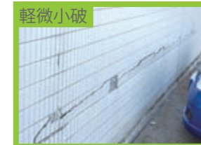
柱・耐力壁の損傷は軽微であるが、RC二次壁等にせん断ひび割れが見られる。
