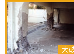
柱のせん断ひび割れ、曲げひび割れによって、鉄筋が座屈し耐力壁に著しい低下がある。
